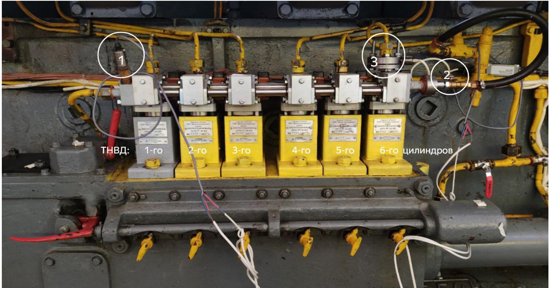
Рисунок 1 – Установка преобразователей давления в топливную систему дизеля. 1 – преобразователь давления в питающем коллекторе низкого давления, 2 - преобразователь давления в отсечном коллекторе низкого давления, 3 – датчик давления впрыска шестого цилиндра.
