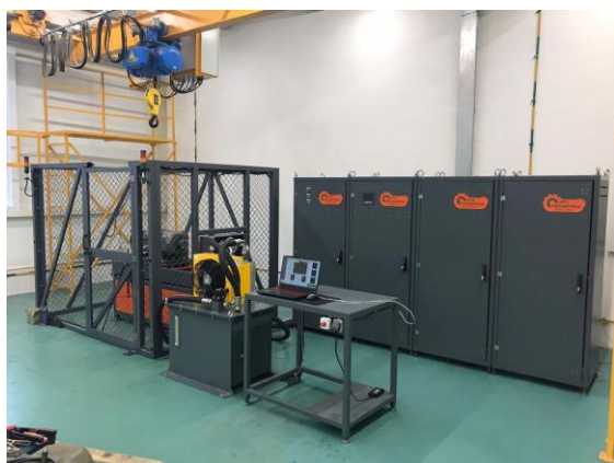
Комплексный стенд проверки асинхронных ТЭД
