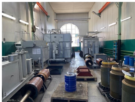
Пропиточно-сушильное отделение электромашинного цеха
